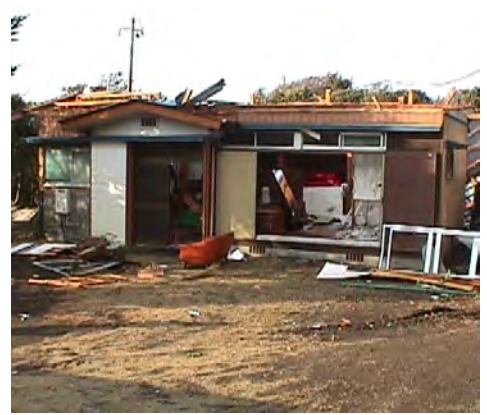
家屋損壊（元町）
