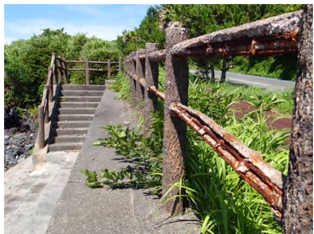
塩害による腐食（万立浜）
