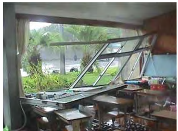
波浮小学校の被害
